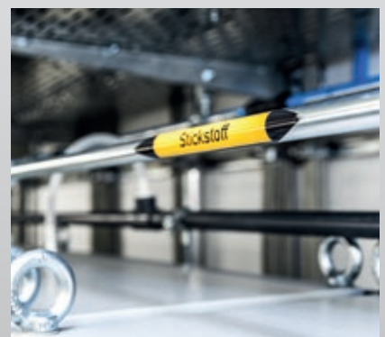
Stickstoff-Löschleitung und Ansaugrohrleitung
