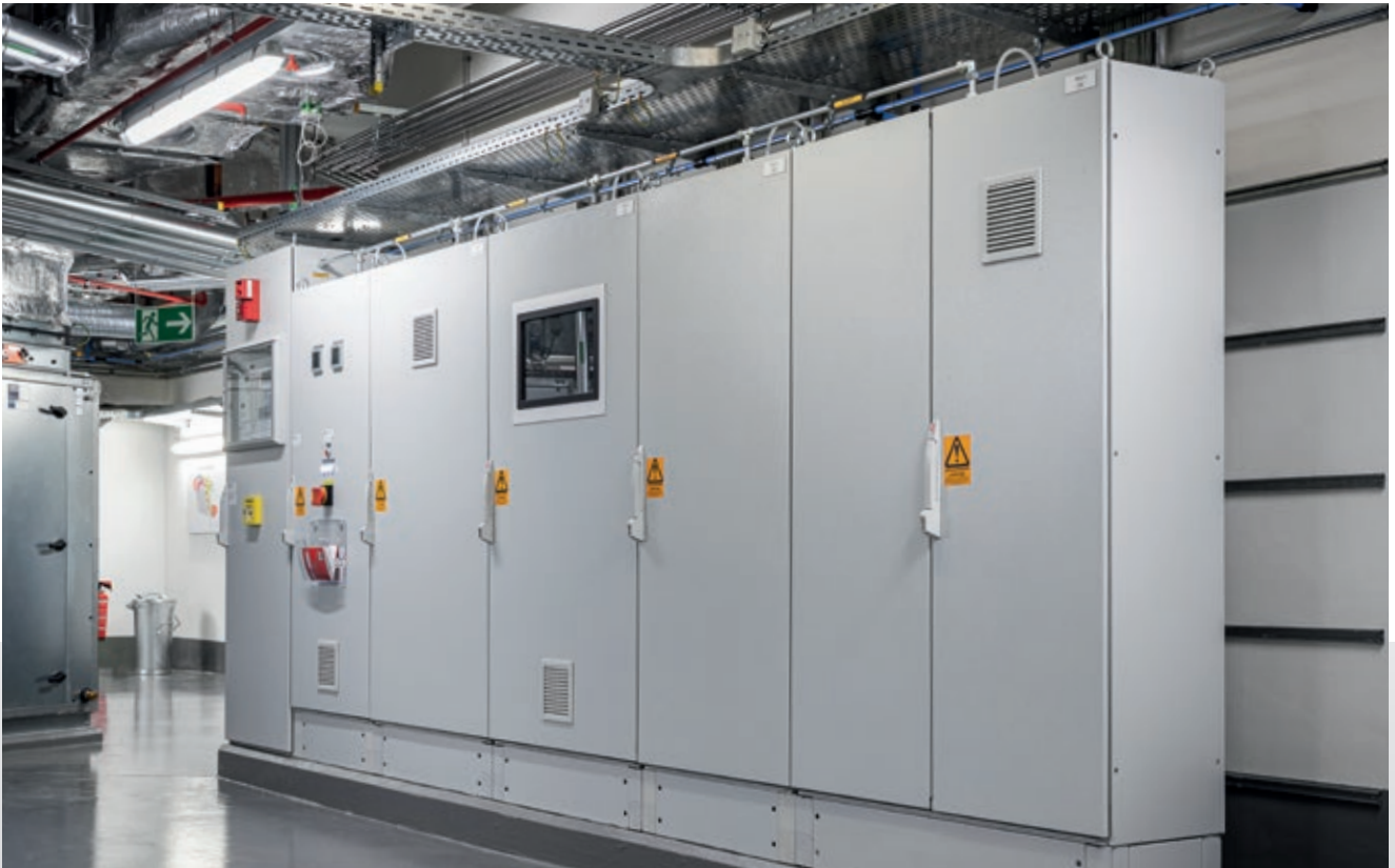
Schaltschränke mit Stickstoff-Löschanlage geschützt
