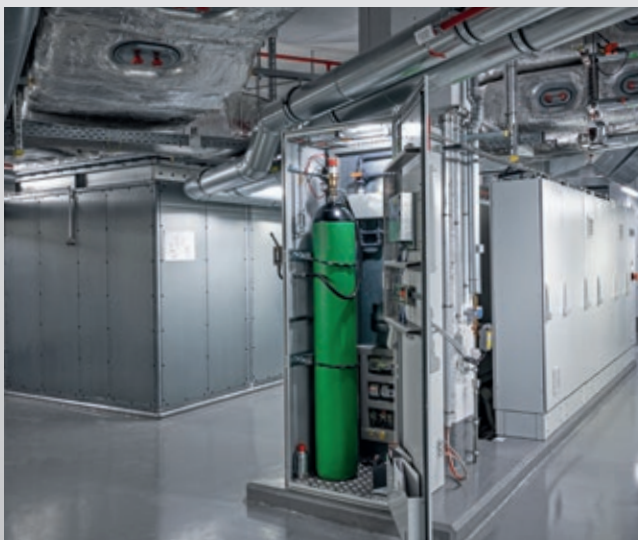
Technikschrank mit Gasflasche
